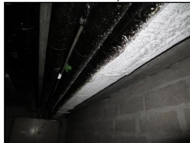
Photo N° 941 AMIANTE CIMENT -- COULOIRS -1 Gainés & coffres horizontaux Ventilation haute (Fibres-ciment)
